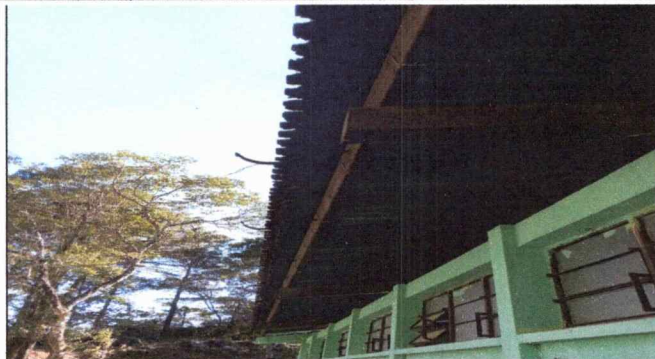
Foto1: Cambio de techo de salon por deterioro, óxido, inclemencia de tiempo y por años de instalación.
